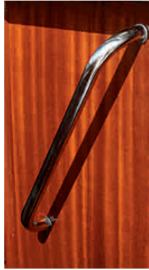
Zu kurz: Handläufe am Niedergang
